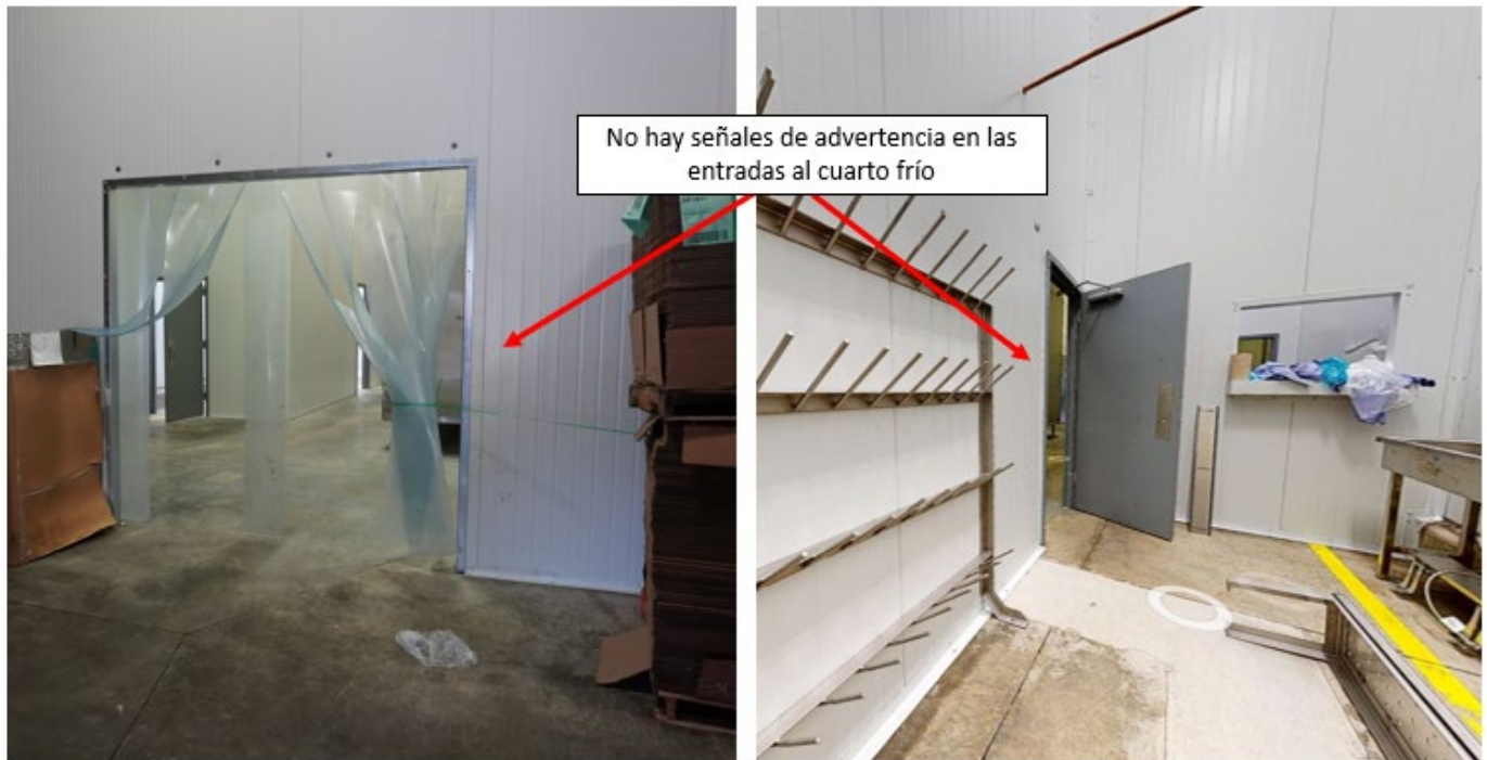
Figura 26. Falta de señales de advertencia de presencia de nitrógeno líquido y peligro de asfixia en el acceso al cuarto frío desde el muelle de carga (izquierda) y cámara estéril (derecha). (Crédito: CSB y Messer)
