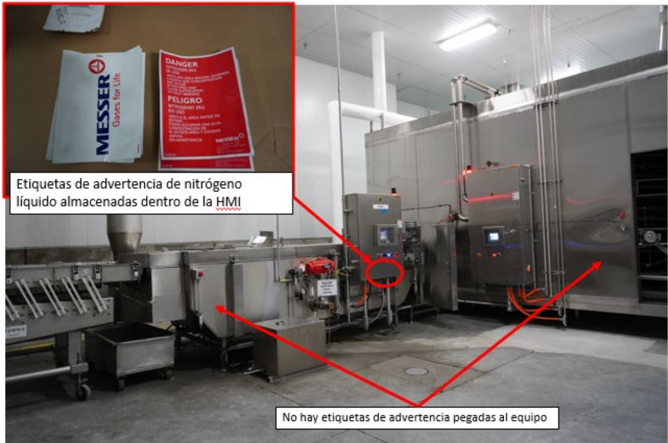
Figura 27. Las etiquetas de advertencia de nitrógeno líquido estaban ubicadas dentro de la HMI y no estaban adheridas al equipo. (Crédito: CSB)
